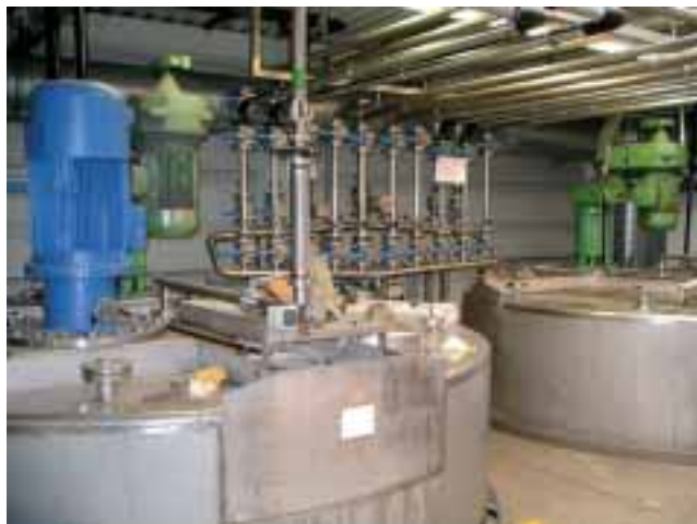
Re-Engineering-Projekt Doppelbatch-Anlage bei Werner & Mertz
