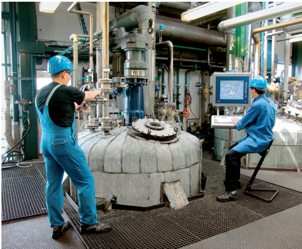
Münzing Chemie migrierte sein Leitsystem PCS7 Version V 4.0 auf das Leitsystem Plant iT vom Proleit. Ein Grund dafür war, dass das bestehende System am Ende seiner Kapazität war und keine zusätzlichen Funktionen mehr ermöglichte.
