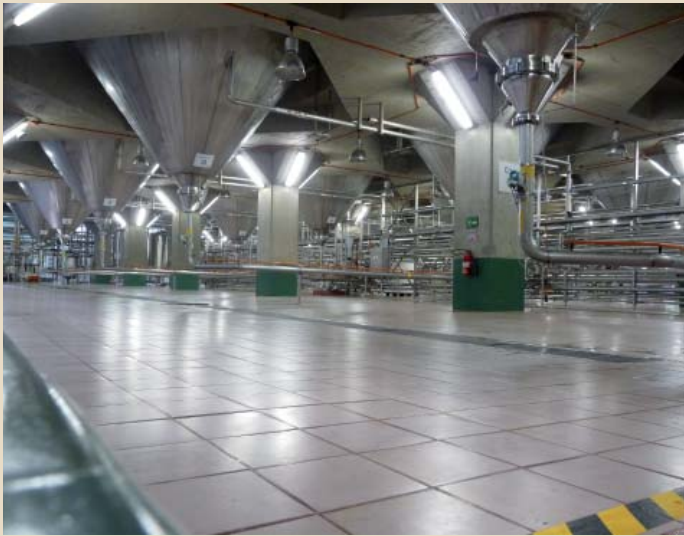
Encaminado complejo en las cavas, automatizado por brewmaxx
